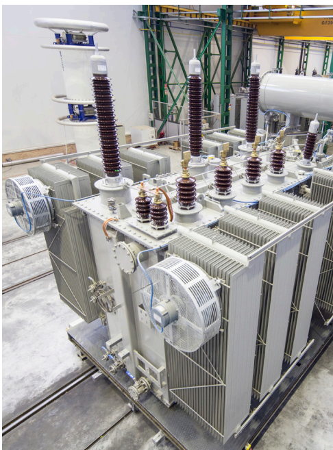
Plataforma para ensayos de potencia
